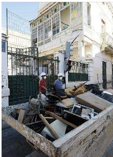
desalojo y vaciado. Los operarios municipales vacían la casa de la palmera. manuel molines
